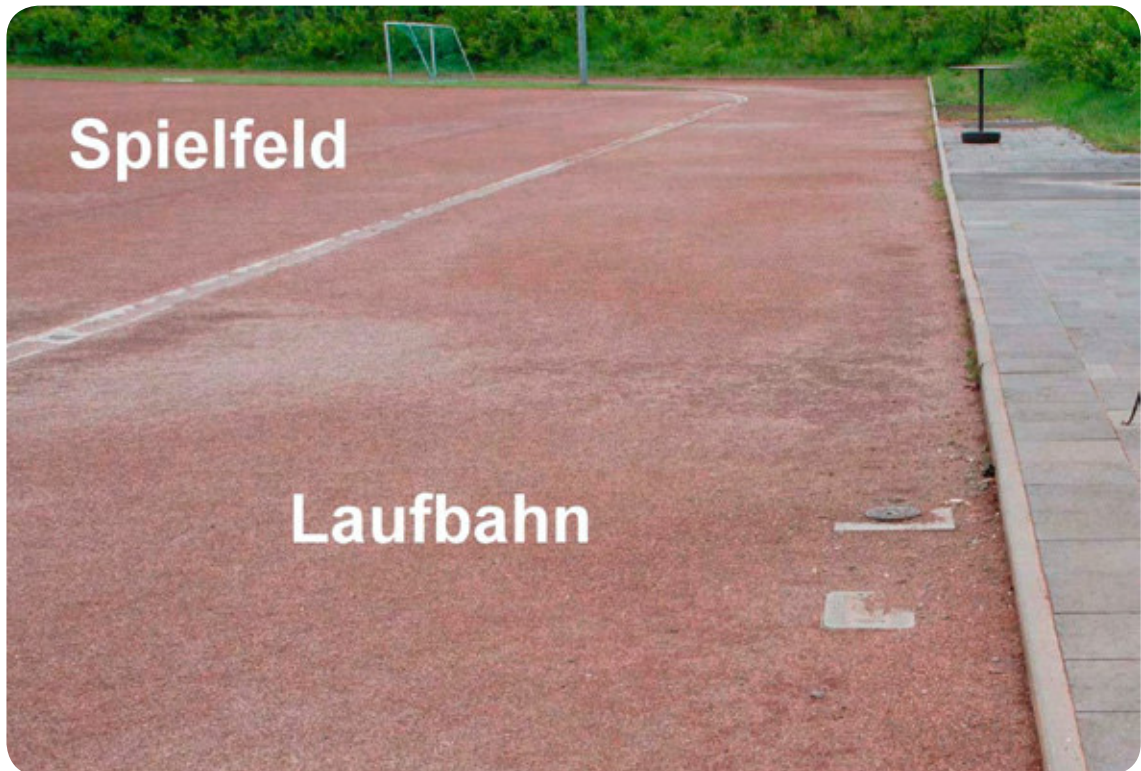
Abb. 133: Schieberkappe und Ventilschacht im hindernisfreien Bereich einer Laufbahn
