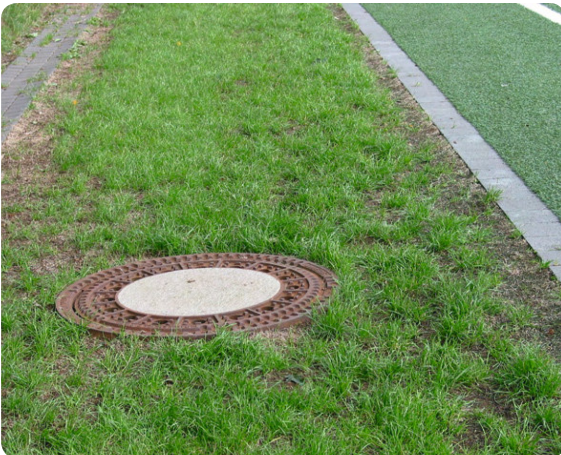
Abb. 132: Schachtdeckel innerhalb des hindernisfreien Raums
